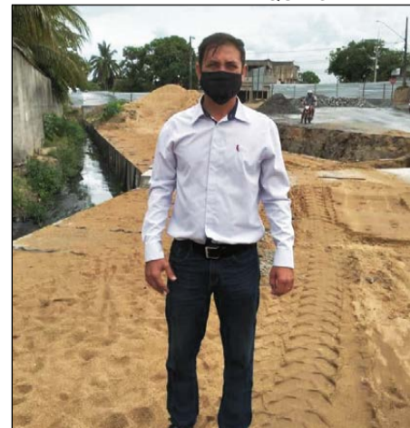
Vicentini acompanhou de perto os serviços de macrodrenagem: “Obra era um sonho da comunidade”
